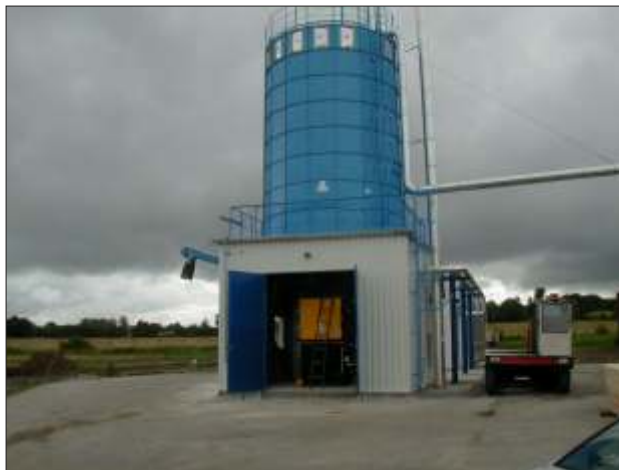
• Zásobník na dřevní palivo nad kotelnou - ZP 5000 (výška 8 m) ve firmě Pila Vráto a.s. (České Budějovice, ČR)
