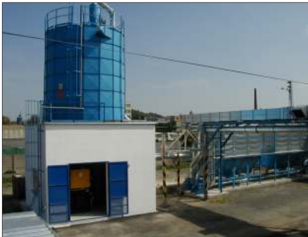
• Zásobník na dřevní palivo nad kotelnou - ZP 5000 (výška 6 m) ve firmě TVAR v.d. (Klatovy, ČR)
